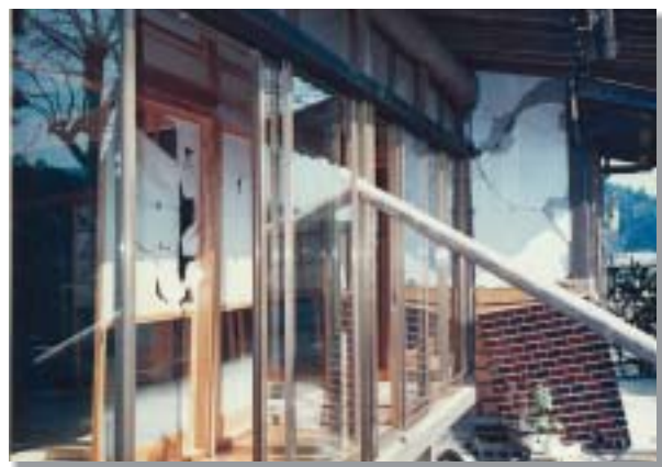
1987年千葉県東方沖地震による民家の被害(長南町) 写真提供 古山 豊氏
