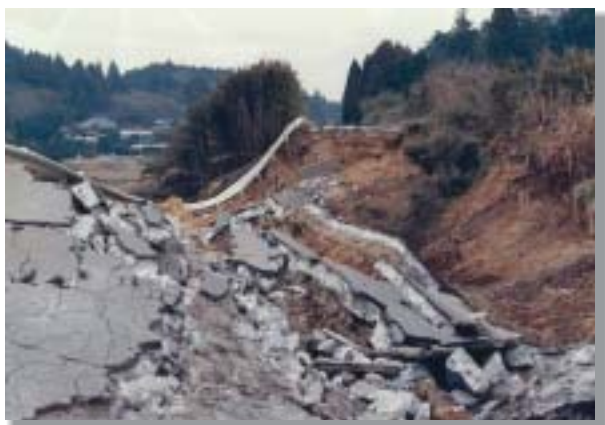
1987年千葉県東方沖地震による道路崩壊(芝山町) 写真提供 古山 豊氏
